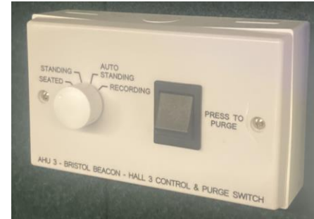
Hall 3 (AHU 03) Fan Speed Controls
