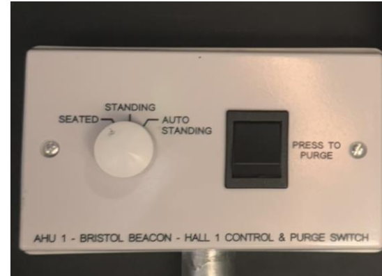
Hall 1 (AHU 01A & 01B) Fan Speed Controls.
